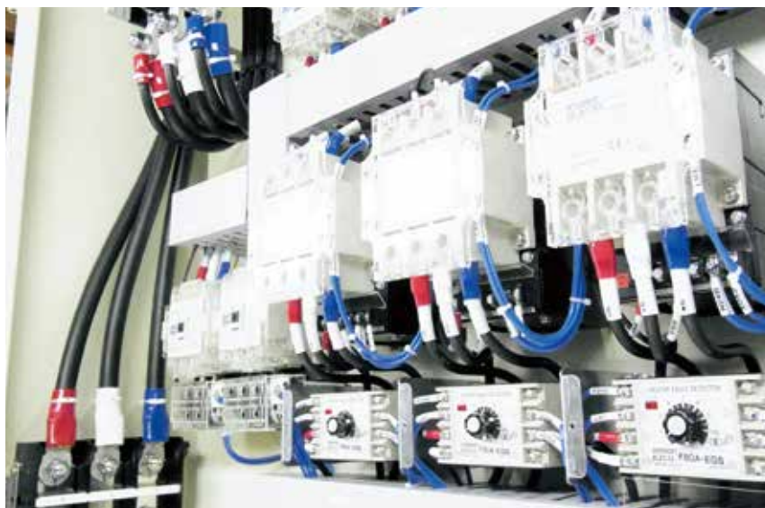
M社様向ヒーター制御盤
