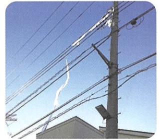
電線にビニールが 引っかかっている
