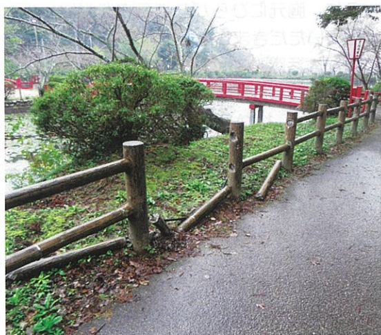
弁天湖脇の柵が損傷していました。大会までに復旧が困難であれば、黄黒ロープやカラーコーン等で立ち入り規制の対策が必要と考えました。
