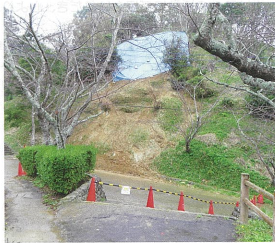
道路側の法面が崩落しているため、立ち入り禁止となっていました。大会まで本復旧が見込めない場合は、立ち入り禁止区画を設ける必要があると考えました。
