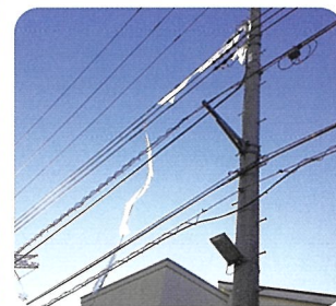
電線にビニールが 引っかかっている
