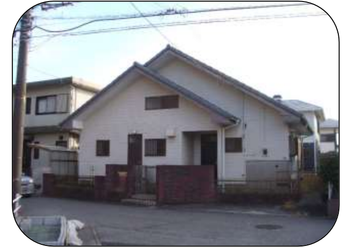
◎良 建物劣化 小有 敷地管理
