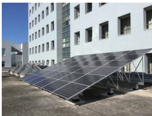
公共施設に設置した太陽光発電施設
