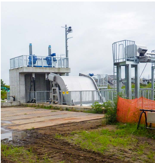
▲鷲巣稲荷前水門ポンプゲート
