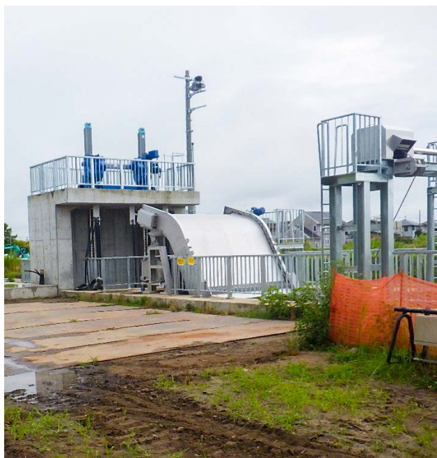
▲鷲巢稲荷前水門ポンプゲート
