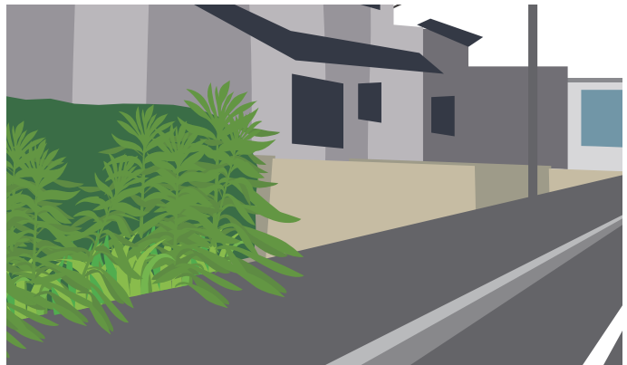
民地からはみ出した草により狭くなった道路
